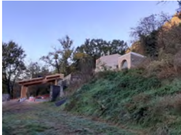
La Solana. Centre de Desenvolupament Forestal, durant la construcció del nou cobert. Font: Arxiu XPN
