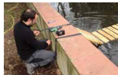
Instal·lació de rampes basculants en basses de rec (Fotografia: Ecotons)
