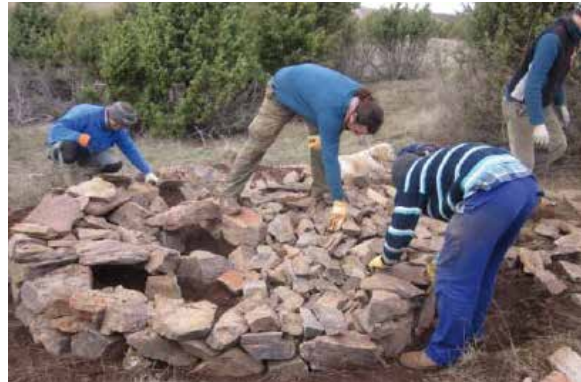
Construcció de la base amb la xarxa de passadissos per a rèptils (Fotografia: Ecotons)
