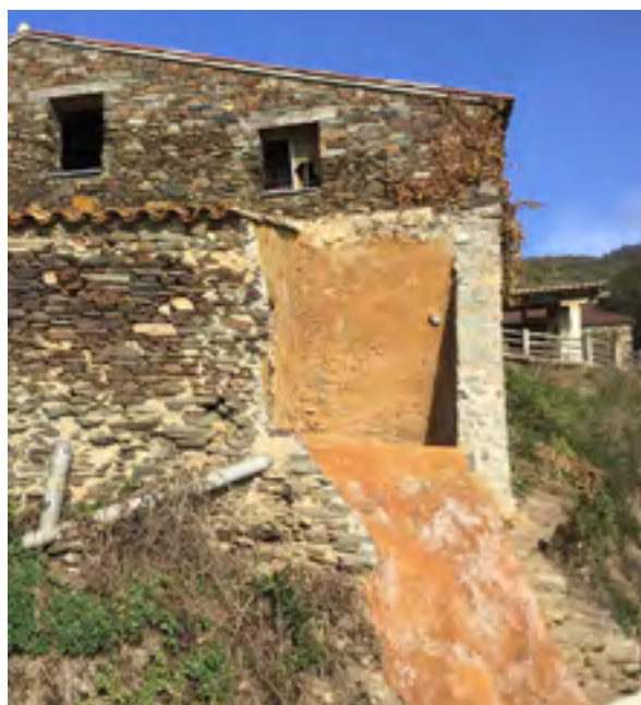
Enderroc parcial del corral de Can Pla. Font: Arxiu PNM
