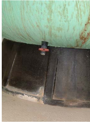
Vàlvula pel buidat de l'aigua d'un filtre
